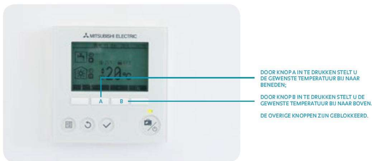
Figuur 2: Thermostaat vloerverwarming woonkamer
